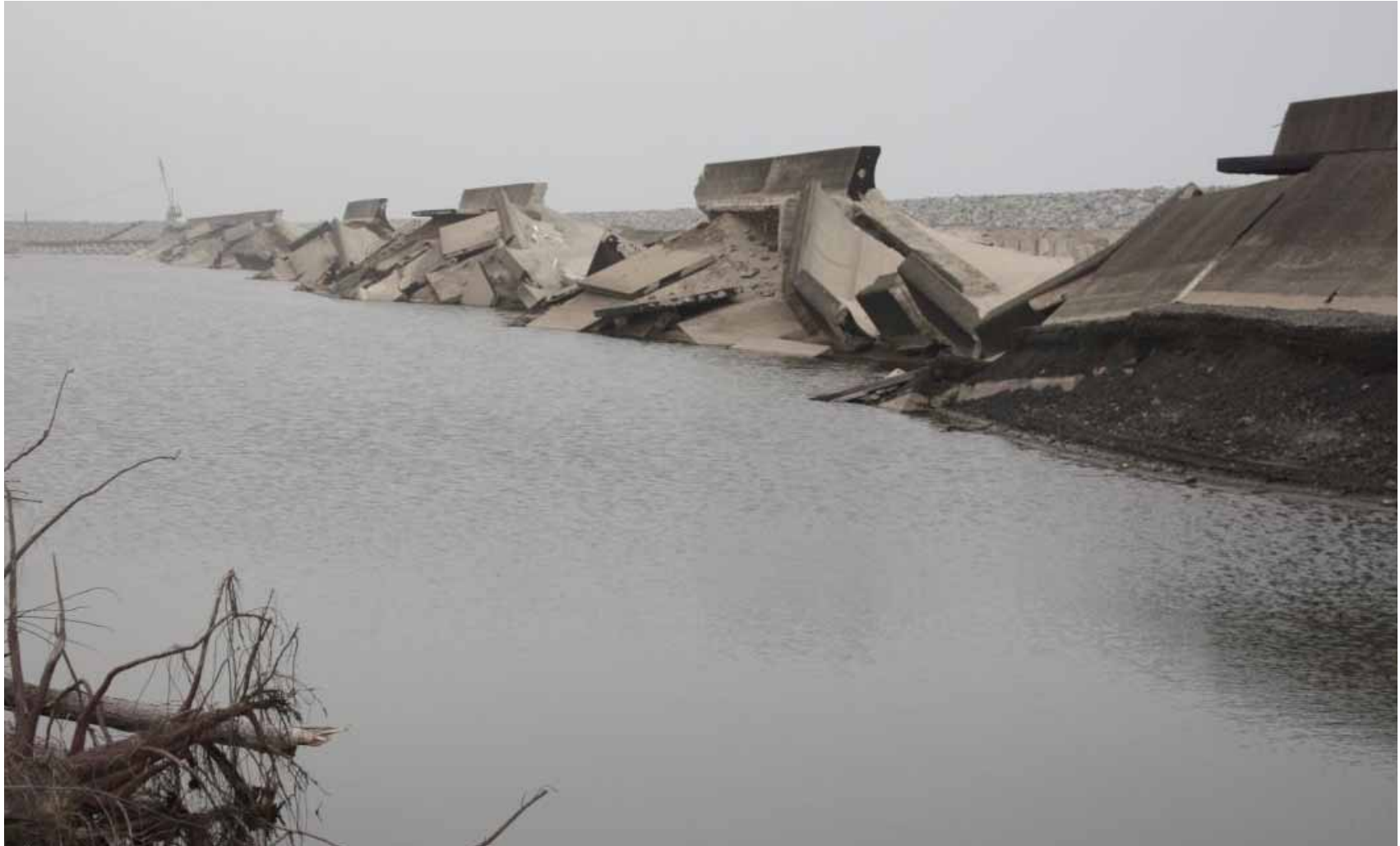
海岸保全施設の被災状況の例 (宮城県亘理町)
